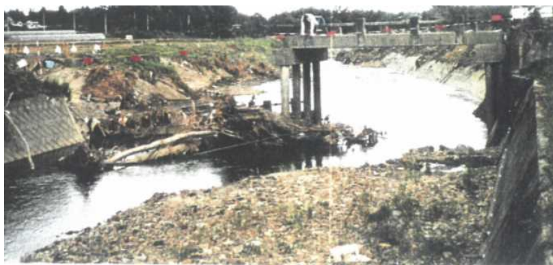
H10.台風第4号_雷神橋破損(泉川)
