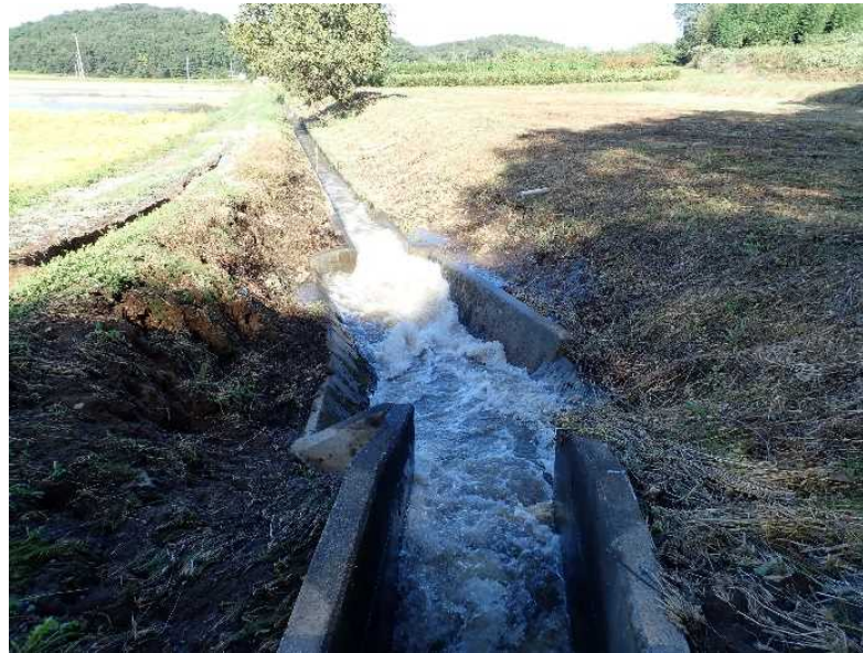
令和元年 東日本台風 太田川地内 水路破損
