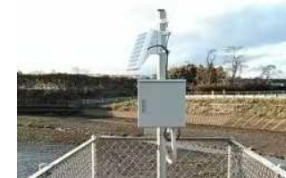
水位計（防災重点ため池）
