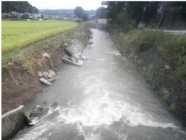
H23.台風15号_護岸破損(阿由里川)
