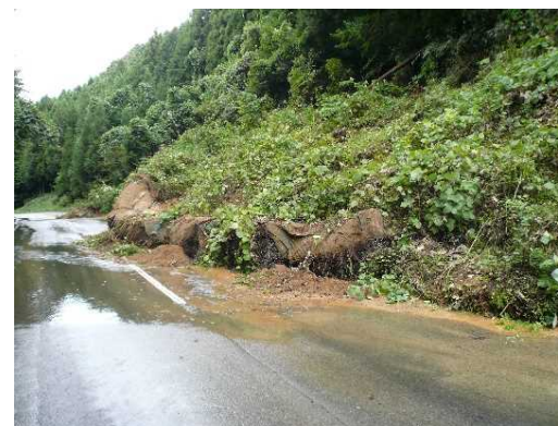
【H23.9.21】 村道戸ノ内丸山線(法面崩落)
