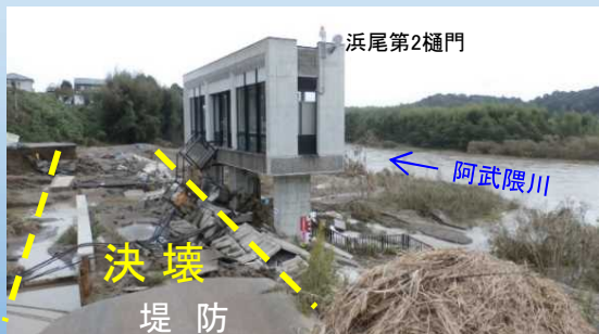
98.6k 左岸堤防決壊箇所(須賀川市)
