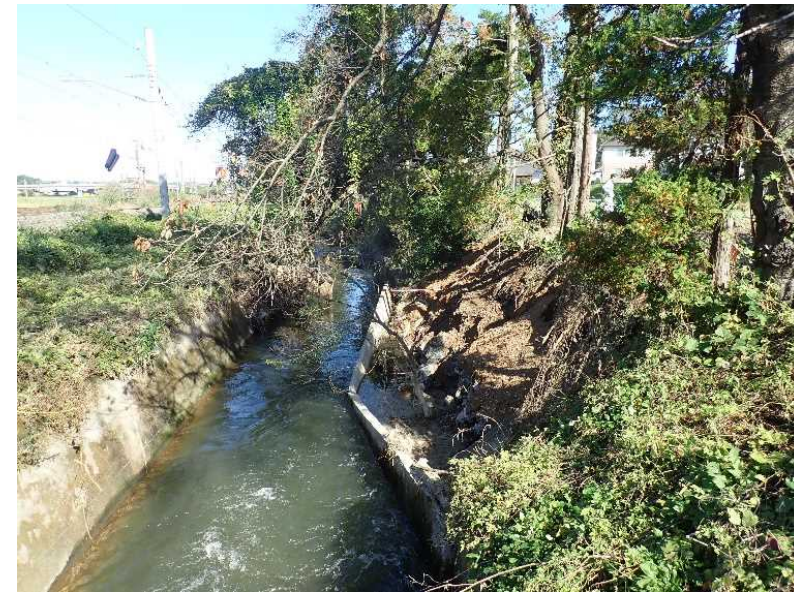
令和元年 東日本台風 準用河川神川 護岸破損
