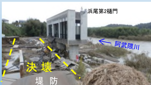
98.6k 左岸堤防決壊箇所(須賀川市)
