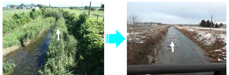
▲ 水無川(鶴岡市) 令和元年度実施 支障木伐採・堆積土砂撤去
