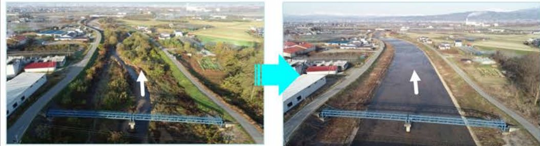
▲ 村山野川(東根市) 令和元年度実施 支障木伐採・堆積土砂撤去
