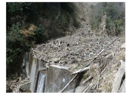
治山ダムが山腹崩壊と土砂流出を軽減した事例【大分県日田市】
