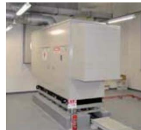
非常用発電設備のイメージ
