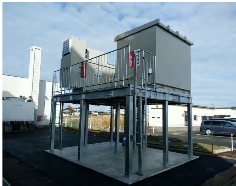
▲約2.5mの架台の上に設置した非常用電源装置
