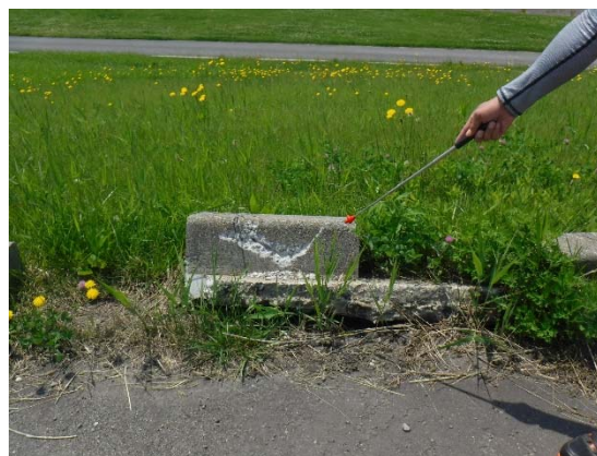
▲坂路の駒止めの損傷
