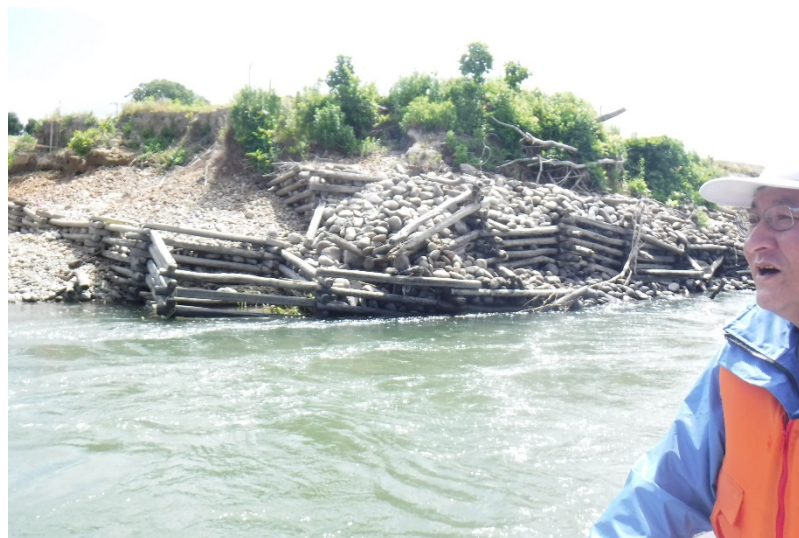
▲H30出水による河岸の状況等を確認
