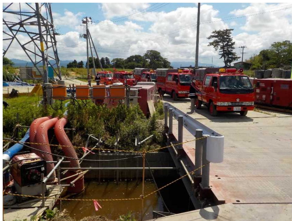
▲ 土口地内の二丁排水では、出動時におけるポンプ設置箇所、ホースラインなどの確認をしました。
