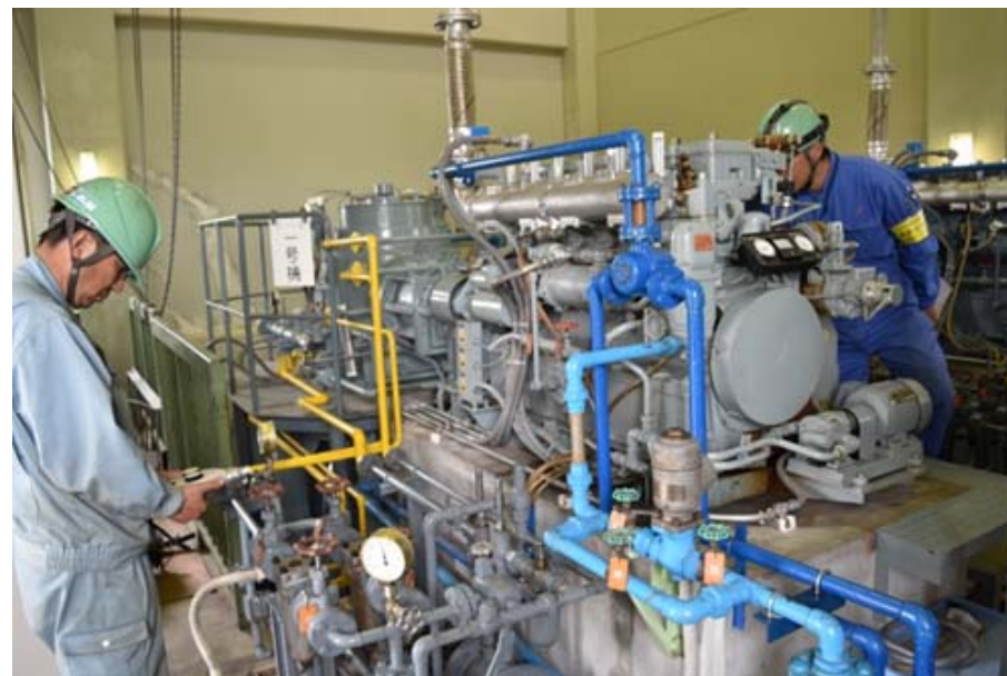
排水機場のポンプ
