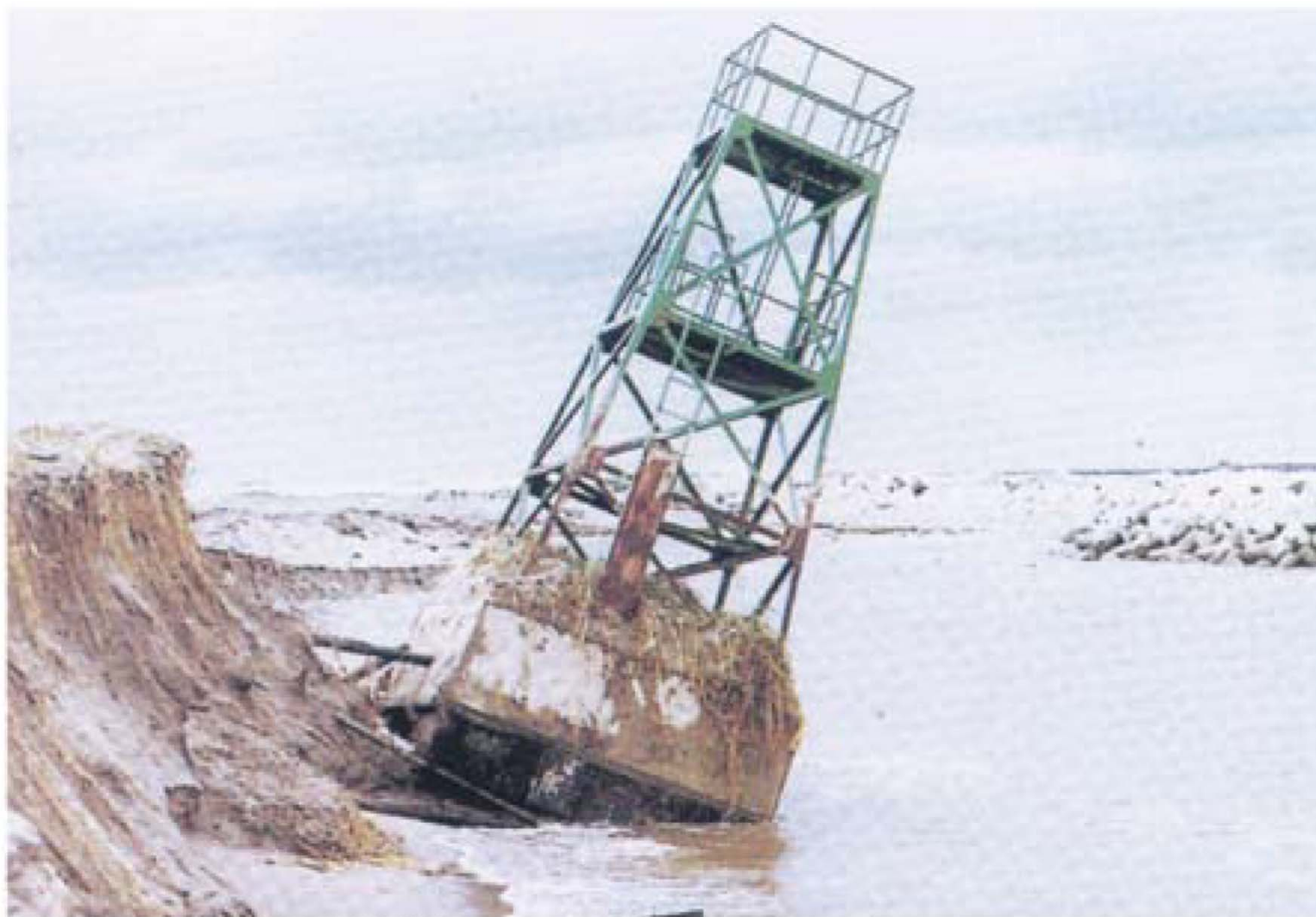
海岸部で監視塔が崩落(酒田市宮野浦地区) 1990年(平成2年)8月
