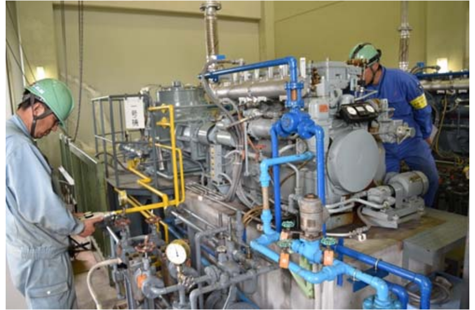
排水機場のポンプ
