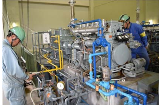
排水機場の定期点検
