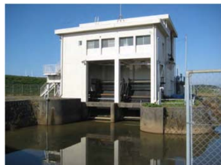
成田排水機場(赤川支川大山川)
