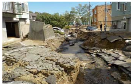
札幌市 液状化による被害 (出典：水害レポート2018 国土交通省)
