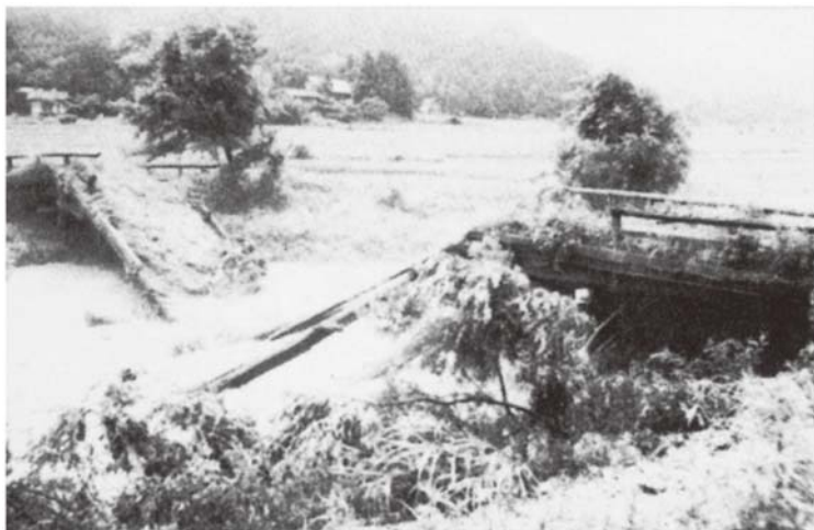
洪水により破壊された木村橋（昭和46年7月 酒田市平田地区）
