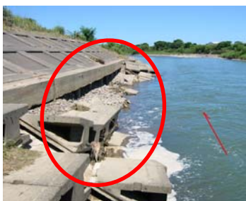
出水による護岸の崩落
