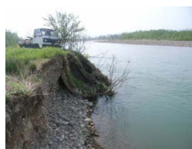
河岸崩壊の状況
