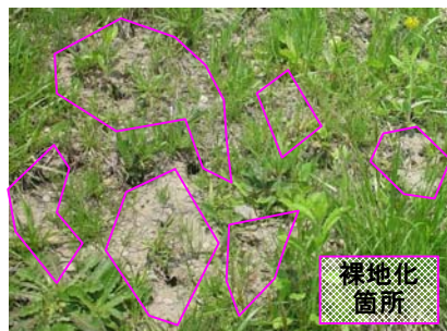
堤防法面の裸地化
