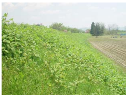
有害な植生(イタドリ等)の繁茂
