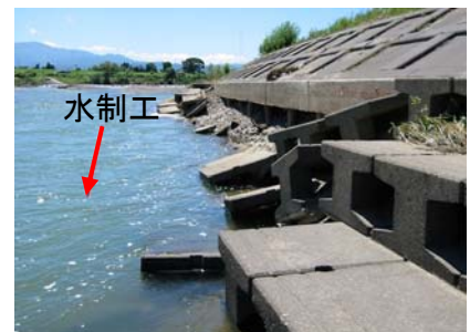
出水における護岸の被災状況
