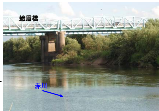
蛾眉橋付近における樹木繁茂状況 (H23. 9 撮影)
