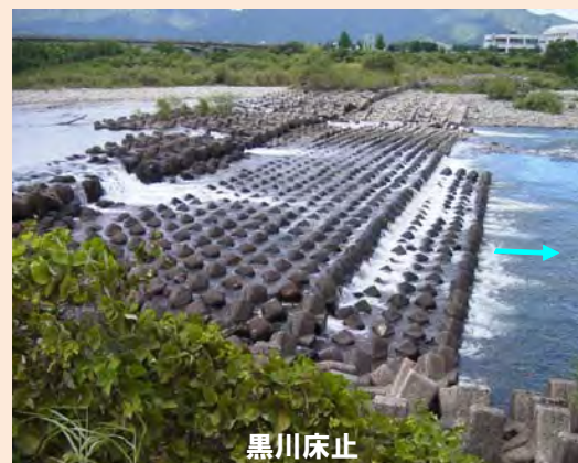
黒川床止 魚類の移動障害となっている床止
