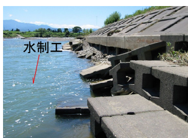
護岸の破損状況
