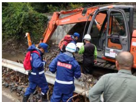
▲工事関係者から被害状況の聞き取り
