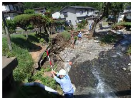
▲河川での被害延長を測定
