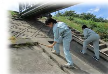
▲ハンマーを用いた打音による護岸背面の空洞状況の調査を体験。
