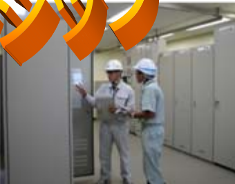
さみだれ大堰の機械室にて。堰の日常点検業務を体験。
