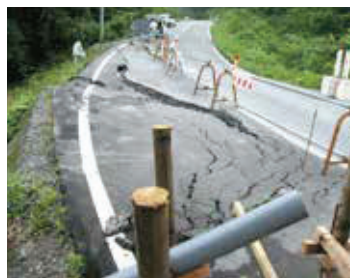
被災状況(H17志津地すべり)
