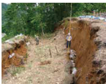
被災状況(H16田麦俣地すべり)
