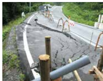
被災状況(H17志津地すべり)
