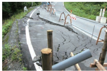
被災状況(H17志津地すべり)
