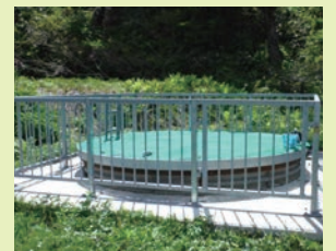
集水井工 豊牧3号集水井
