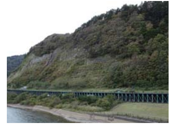
法枠工 (国道47号線沿い) 道路を守るため、崩れる危険のあるがけを、コンクリートの枠でおさえている。
