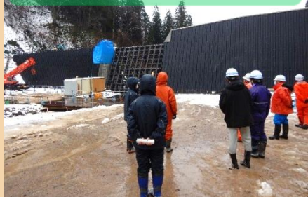
横岫沢砂防堰堤工事 (間近で見る砂防堰堤は迫力あります!)
