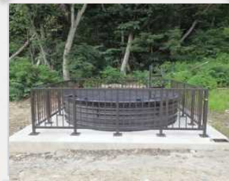
しゅうすいせい 集水井
