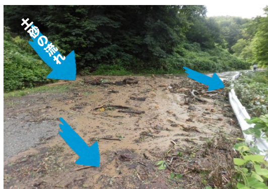
↑赤砂川 赤砂第8砂防堰堤管理用道路 斜面の沢から土砂や倒木が流れ出し、 管理用道路を覆っている状況。
