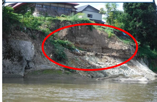
大浦地区(52k付近) 法崩れ
