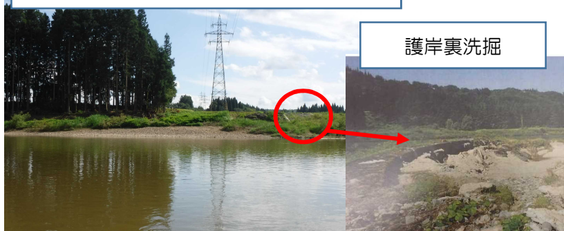
毒沢地区(40.2k左岸) 護岸周辺の損傷
