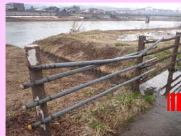
親水公園 転落防止柵の破損
