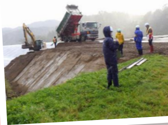
▲最上川中流白須賀地区 河道掘削工事 点検場所: [舟形町富田地区]
