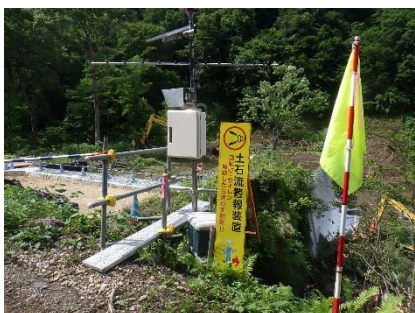
写真-6 土石流センサー
