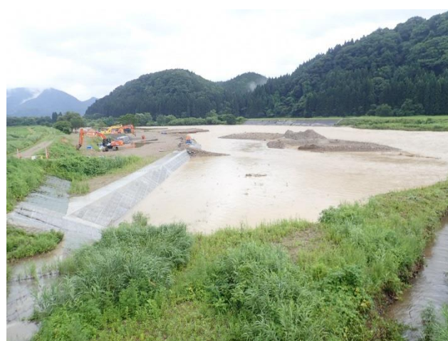
【7月25日 大雨による増水状況 被害あり】
