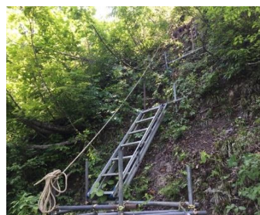
被災現場状況
