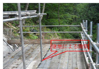
建地による隙間
