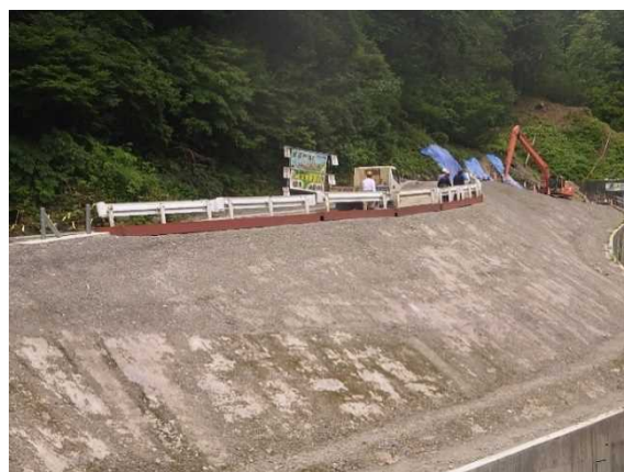
写真7. 法面からの転落・墜落防止対策
