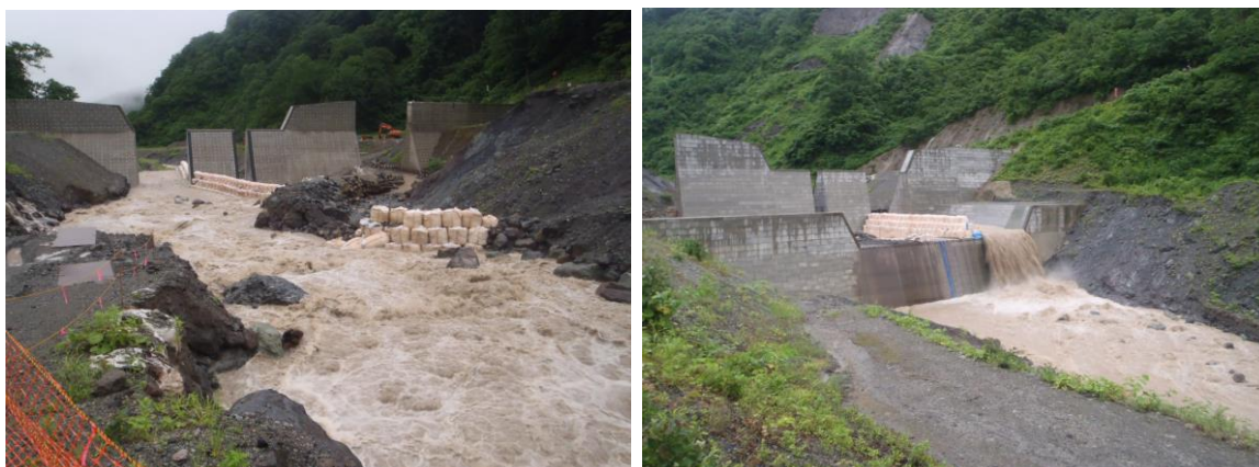
7月1日 大雨による被災状況
