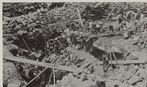
昭和17年 5月27日 立谷沢本沢濁沢第3 号副堰堤排水路掘削 並に締め切りの状況
