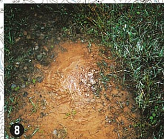
富田地区の堤体漏水状況(舟形町)
