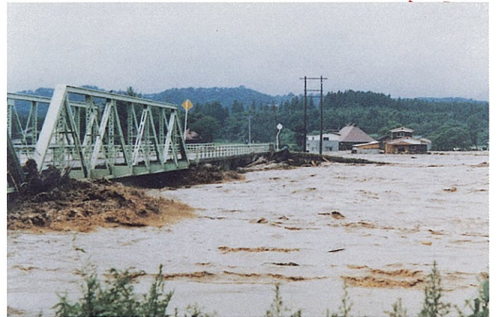
最上川支川真室川 昭和50年8月6日 最上郡真室川町 流出寸前の真鶴橋
