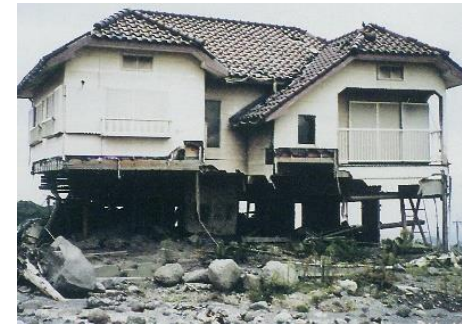
土石流による家屋被害(雲仙)
