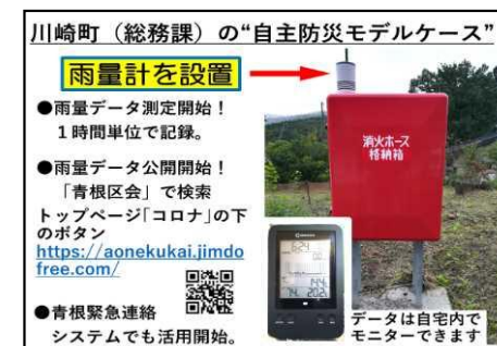
雨量計設置状況(防災組織HPより)
