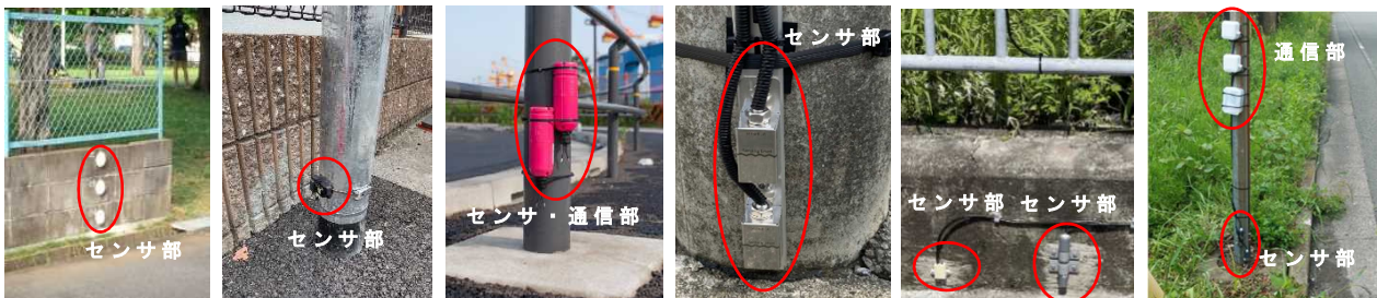
実証実験で設置した浸水センサの設置事例
