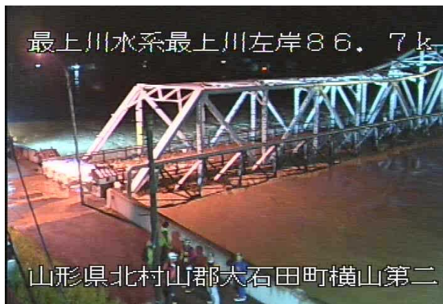
R2.7洪水でのCCTVカメラ画像 (大石田大橋)
