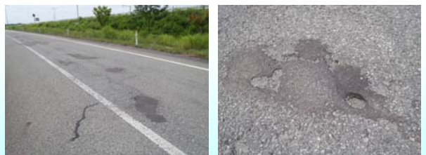
尾花沢新庄道路の傷んだ路面状況
