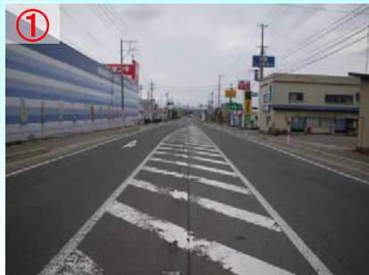
① 補修前 小さなでこぼこや亀裂などで路面が傷んでいました
