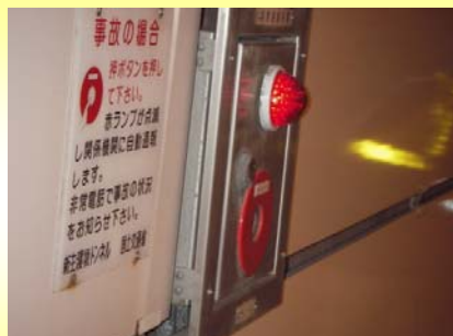
押しボタン式通報装置（50mおき）
