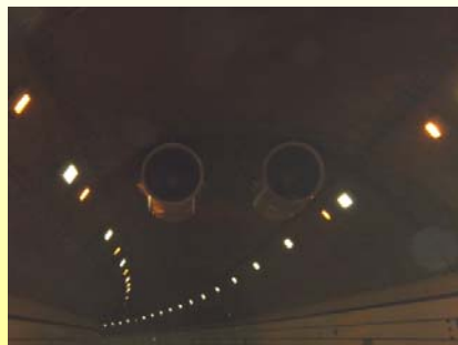
鎮火後、ジェットファンによるトンネル内の排煙操作を実施
