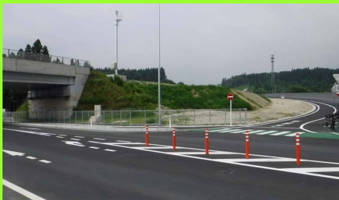
ラバーポール、路面標示
