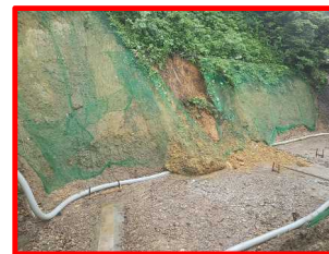
施工途中に掘削した斜面が崩壊
