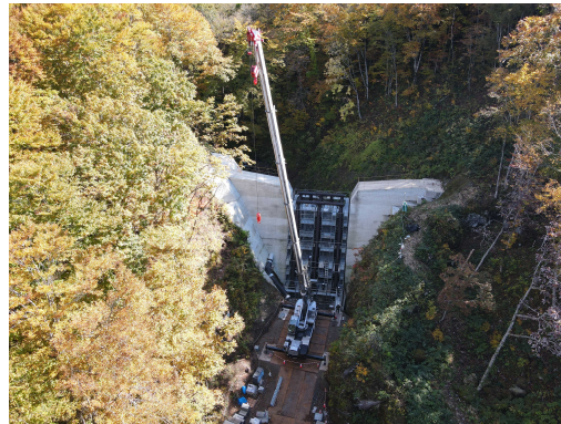
水沢第3砂防堰堤
