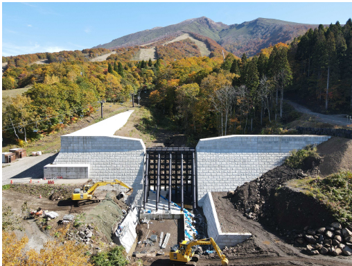
水沢第2砂防堰堤
