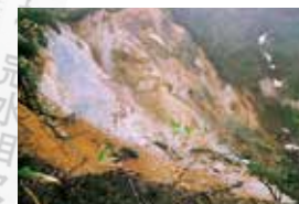
土砂崩落状況
