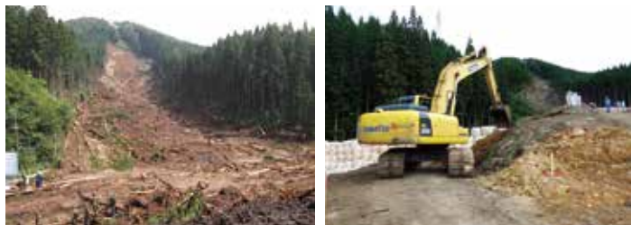
土砂崩落状況(平成25年8月10日撮影)
