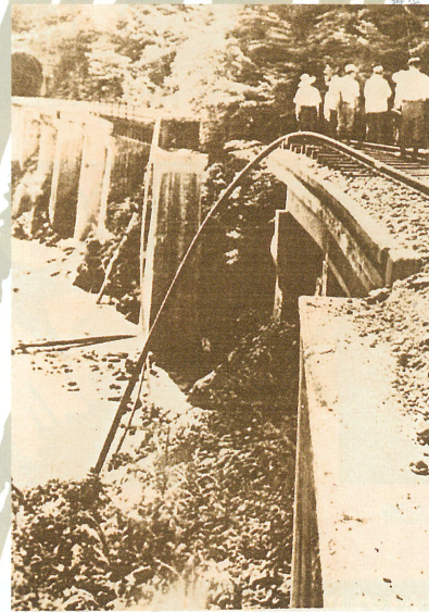
JR田沢湖線の鉄橋も破壊された
