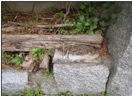
▲花壇の木材が腐食し、釘が露出していました。 (秋田市:仁井田運動広場)
