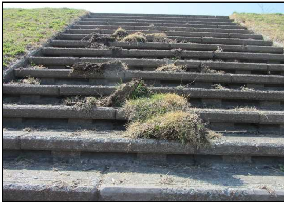
▲階段護岸に土砂の堆積がありました。 (能代市二ツ井町荷揚場地区)
