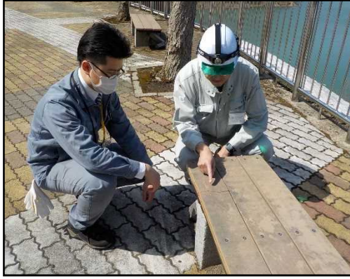
▲ベンチの損傷(亀裂)が確認されました。 (仙北市:玉川ダム上流地区)
