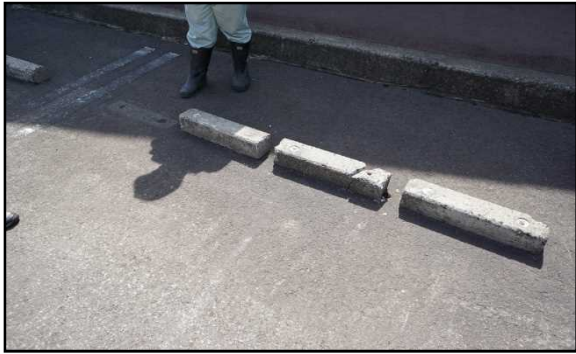
▲駐車場車止めの浮き上がり、破損が確認されました。 (北秋田市:森吉山ダム広報館)
