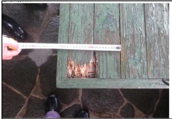
▲東屋ベンチが破損していました。 (由利本荘市:ゆりさくら公園)
