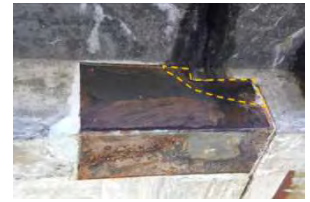
▲ゲルバー部鋼板撤去後状況
