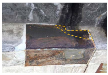
▲ゲルバー部鋼板撤去後状況
