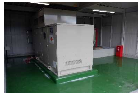
非常用電源装置
